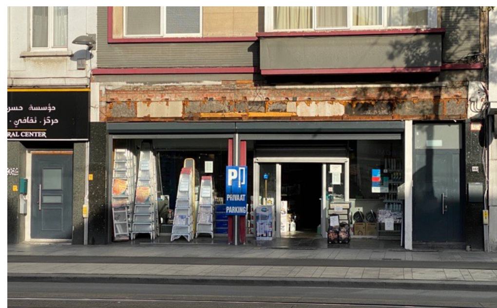
Slecht onderhouden gevel zonder gevelreclame: verwaarlozing komt hier in aanmerking (volledige gevelbreedte).
