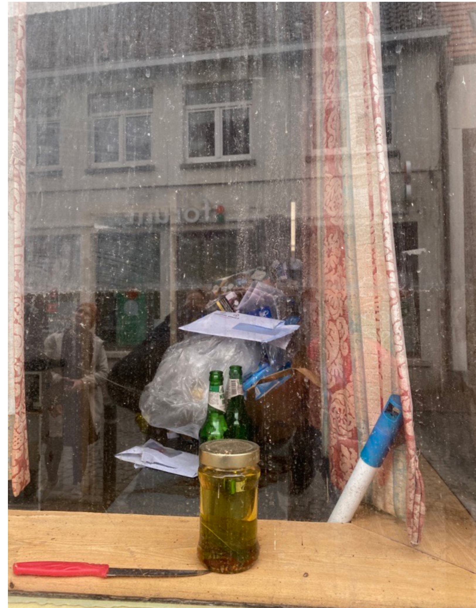
Niet onderhouden handelspand.
