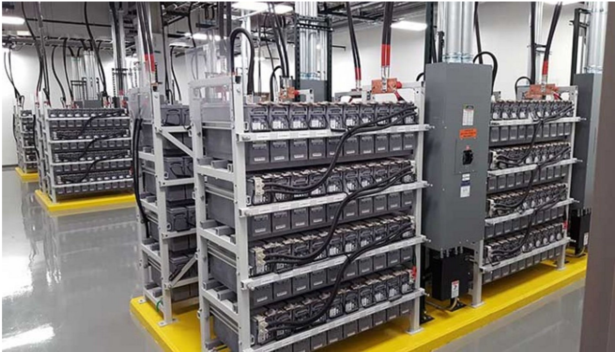
Figuur 15: Voorbeelden van een loodzuurbatterijlokaal voor het leveren van noodstroom (bron: serverroomenvironments.co.uk)
