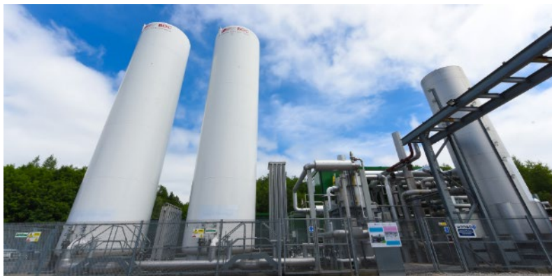
Figuur 32 Installatie voor energieopslag met vloeibare lucht in Manchester (bron : Highview Power)
