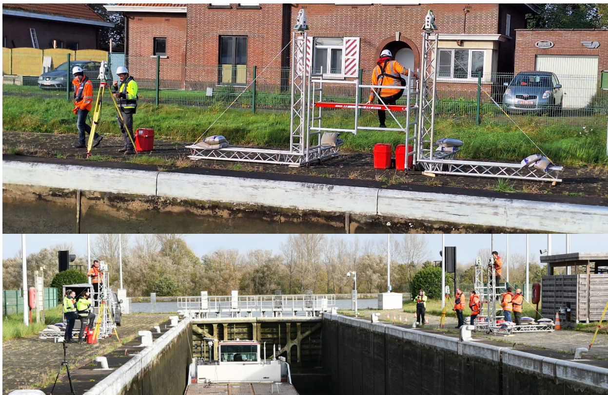
boven: portiek totaalstation met tussenliggend platform voor bediening onder: portieken gepositioneerd aan weerszijden sluisplatform
